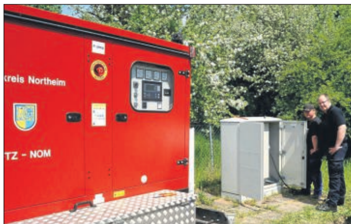
Stromversorgung: Steven Bomhauer (rechts), Leiter der FTZ Norheim, und Marcus Heiligenstadt, stellvertretender Wasserwart der Gemeinde, am Gillersheimer Hochbehälter. Foto: Weiss
